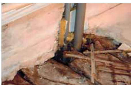
Коммунальная квартира в д. 209 на наб. Обводного канала. Осмотр перекрытий между первым и вторым этажами.
