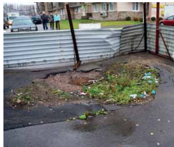
Провал грунта у канализационного коллектора в квартале «Новая Скандинавия».
